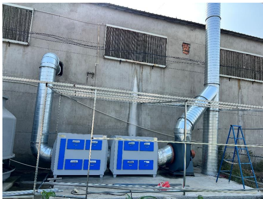
图 3-2 项目废气处理设施照片
