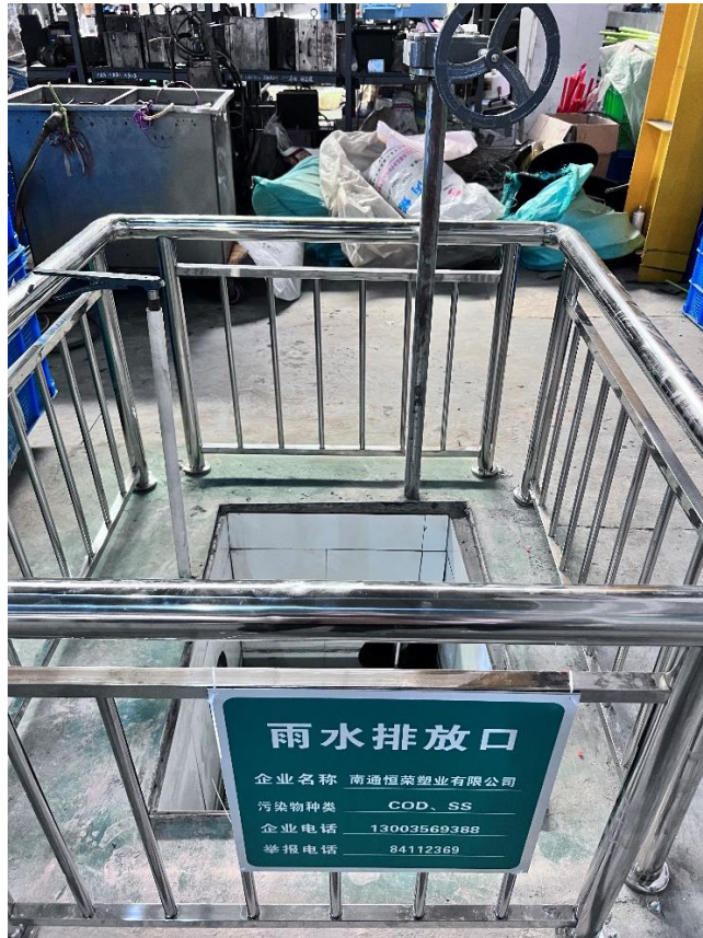
图 3-5 雨水排口及控制闸阀照片
