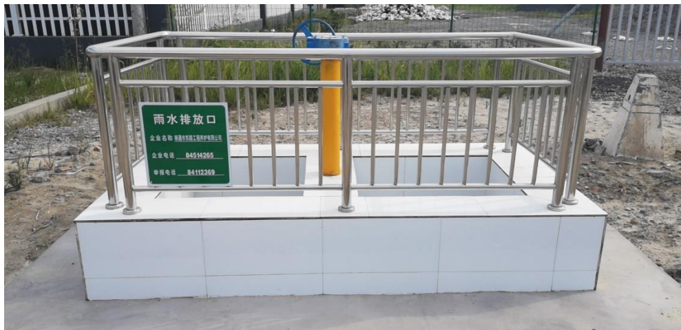
图 4-5 雨水排口规范化照片
