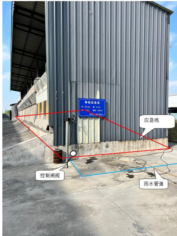
图 4-4 事故应急池及控制闸阀照片
