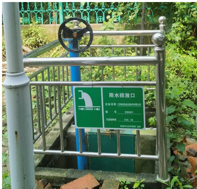
图 3-5 雨水排口及控制闸阀照片
