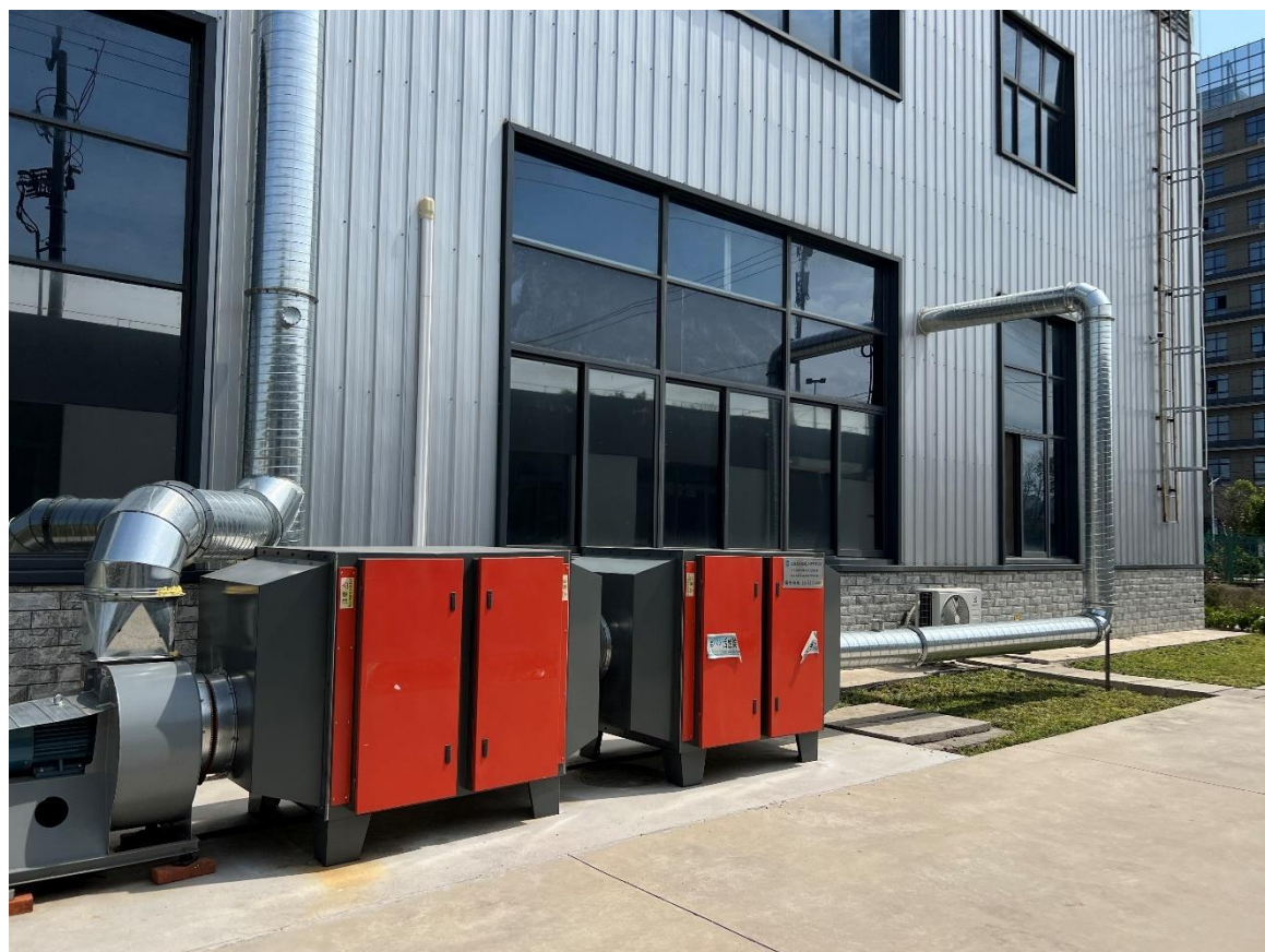
图 3-2 项目废气处理设施照片
